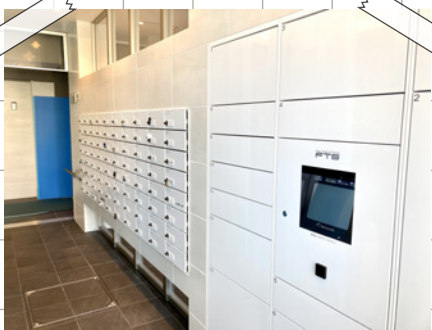
△新なぎさ棟の宅配ボックス
